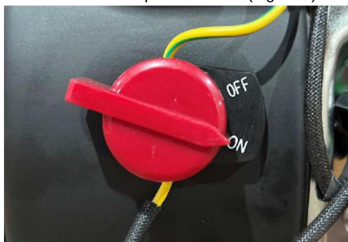
Figura 5: Interruptor corta corriente.
